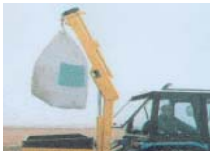
Fig. 13 - Carico della tramoggia mediante apparecchiatura di sollevamento.
